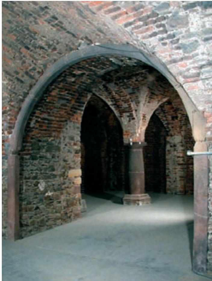
Im 18. Jahrhundert wurden die tiefen, mittelalterlichen Keller des Peterhofs mit Gewölben versehen.
