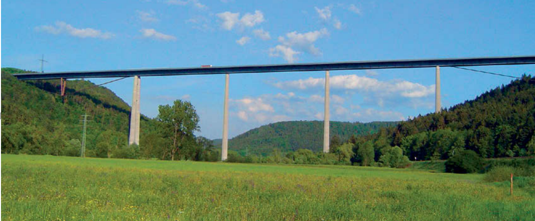
An der Neckartalbrücke in Weitingen, Landkreis Freudenstadt, forscht Leo Reindl an einem Netzwerk autarker Funksensorknoten, die den Zustand der Brücke überwachen. Ein Masterknoten sendet die Daten an einen Server, der sie auswertet und veranschaulicht. Foto: Karl Gotsch
