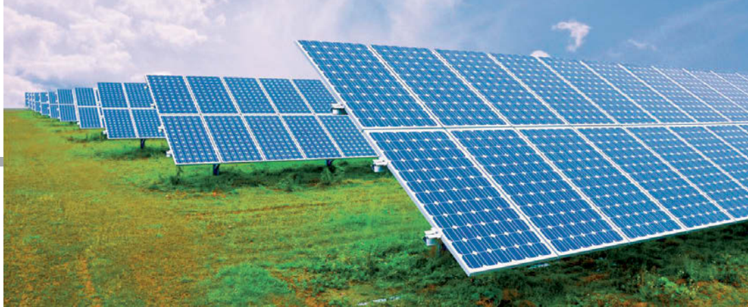
Module einzeln überwachen: Die Aufwecktechnik der SmartExergy WMS, einer Ausgründung der Universität Freiburg, erhöht den Ertrag und die Sicherheit von Fotovoltaikanlagen. Foto: Michel Angelo/Fotolia
